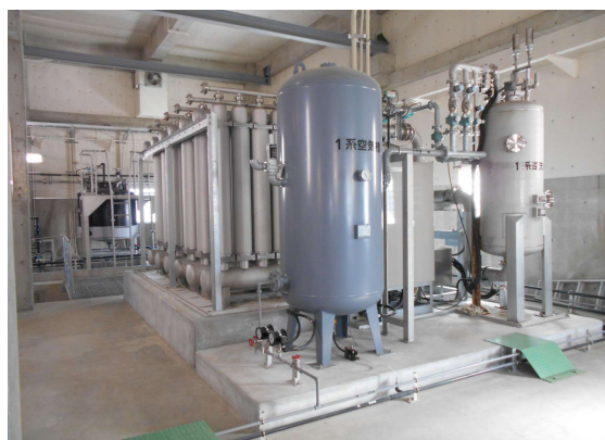
児玉浄水場 膜ろ過装置
