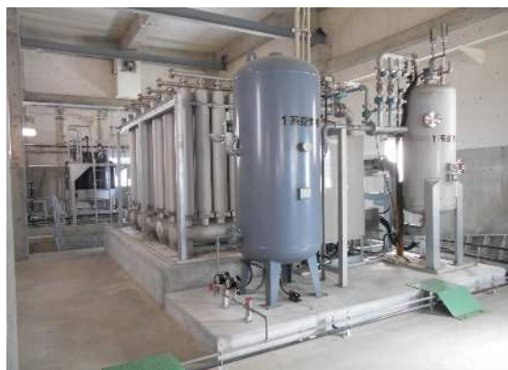
児玉浄水場 膜ろ過装置
