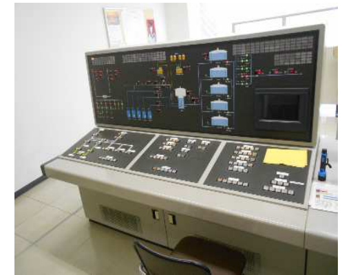
更新予定の都島浄水場監視装置
