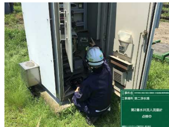
計装設備点検業務の状況
