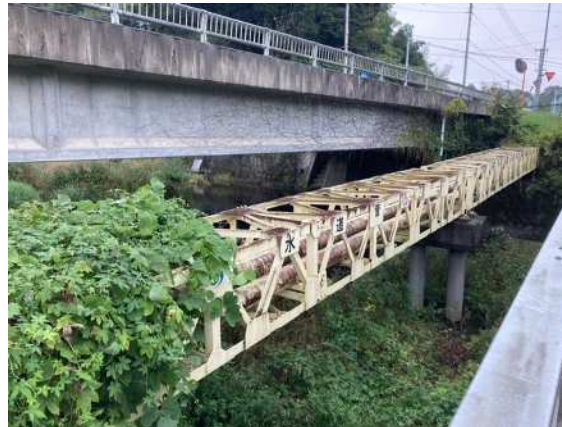
水管橋(新元田橋付近／児玉町元田地内) 厚生労働省資料より参照
