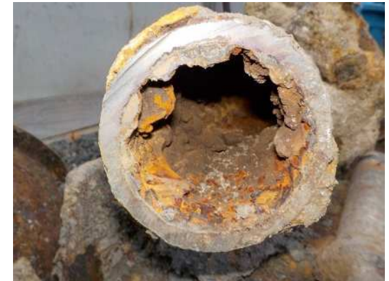
老朽化による管内部の腐食状況
