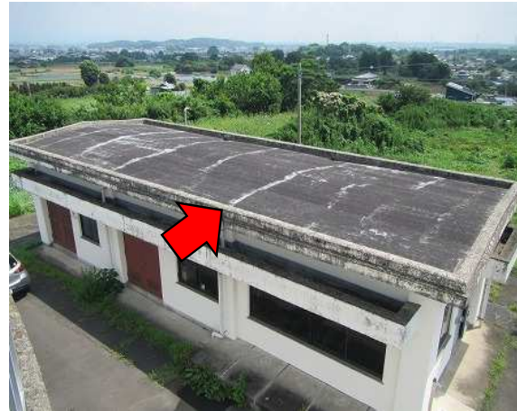
高柳配水場管理棟の屋上部の劣化
