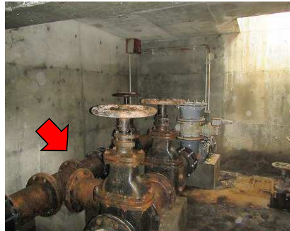
高柳配水場場内配管の老朽化
