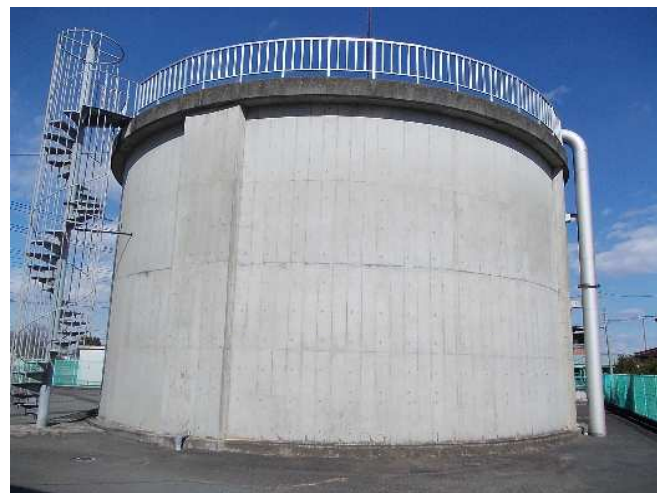
下真下受水場 配水池
