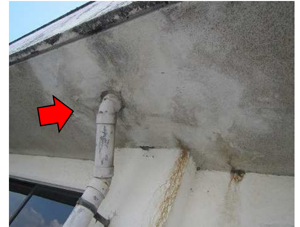
管理棟のコンクリート部の劣化
