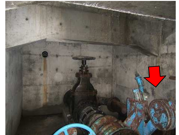
高柳配水場緊急遮断弁の老朽化
