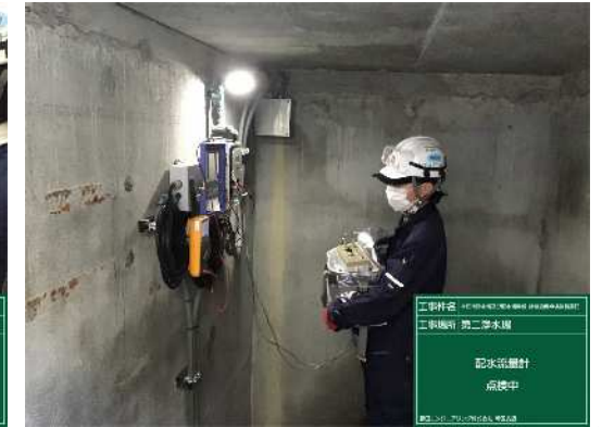
電気設備の点検状況(流量計)
