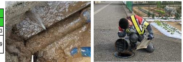
【配水管漏水の状況】
