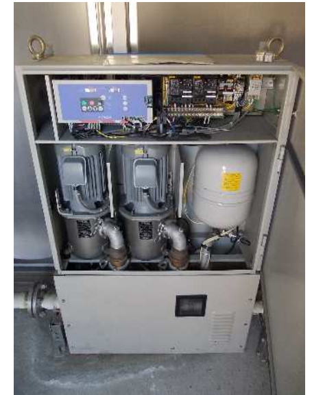
太駄上送水ポンプ場・沢戸加圧ポンプ場送水設備の更新
