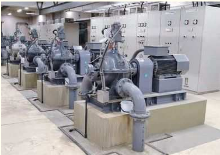
▲ 第二浄水場 ポンプ設備
