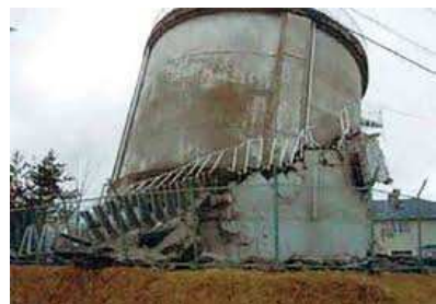
地震災害により倒壊した配水場 (厚生労働省健康局水道課資料より参照)
