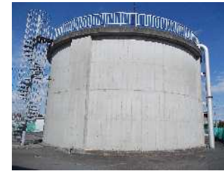
下真下受水場 配水池
