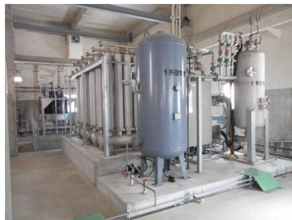
膜モジュールユニット
