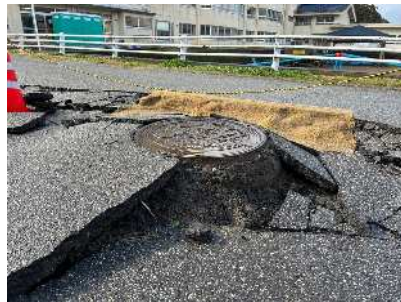
マンホールが浮上し段差が発生
