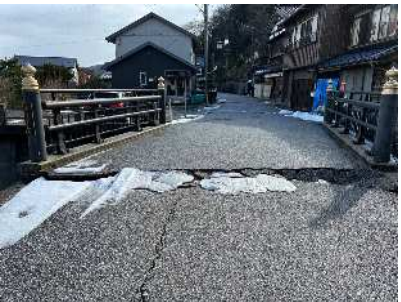
橋と道路に段差が発生
