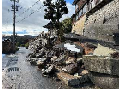
擁壁が崩壊し道路を塞ぐ
