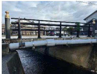
橋に添架した水道管が曲る
