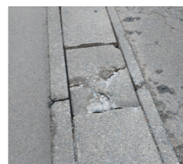
破損した側溝のふた
