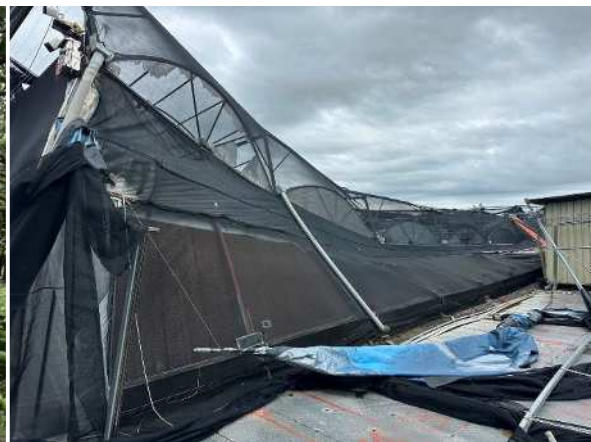
建造物にも被害
