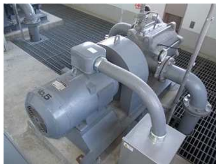
更新予定設備（下真下受水場送水ポンプ）
