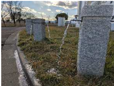
第二浄水場 応急給水栓
