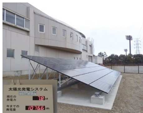
本庄総合公園体育館太陽光発電設備
