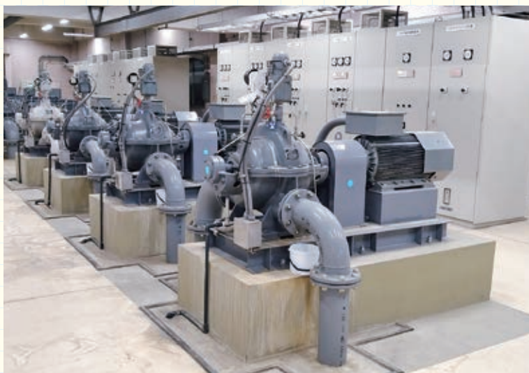
▲ 第二浄水場 ポンプ設備
