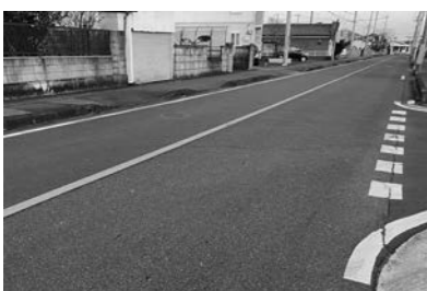
車道と歩道の段差の大きい、危険な歩道
