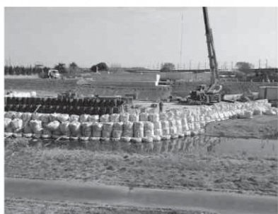
小山川橋梁工事 (シルクドーム付近から深谷方面を撮影)
