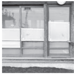
割れて応急処置をした保育園のガラス窓
