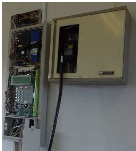
ウ 総合警備保障の監視盤
