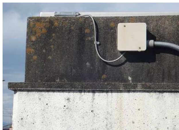
ポンプ井点検口の開閉検知装置
