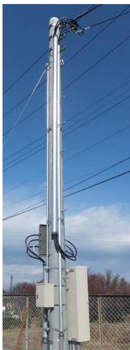
ア 新設引込柱(開閉器)
