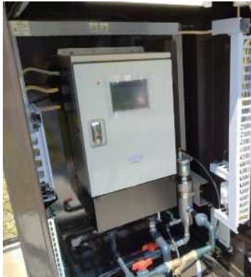
既設水質自動計測装置
