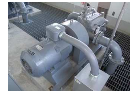
更新予定設備（下真下受水場送水ポンプ）
