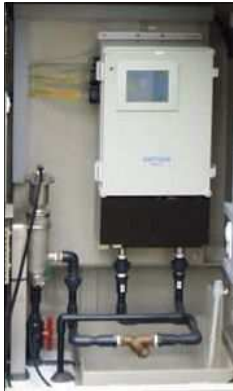
既設水質自動計測装置
