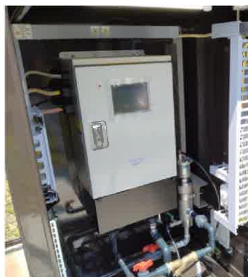
既設水質自動計測装置
