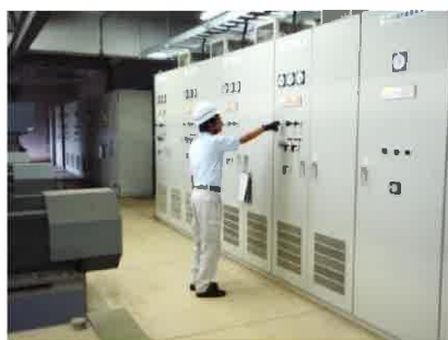
電気設備の点検
