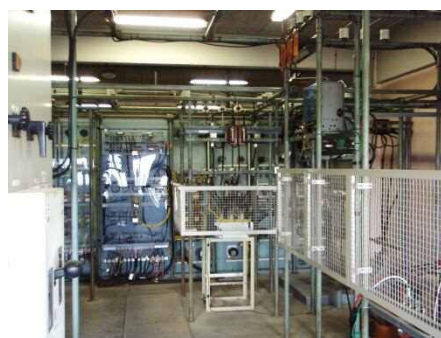
更新予定設備（第二浄水場受変電設備）
