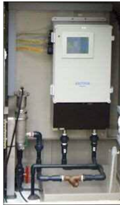
既設水質自動計測装置
