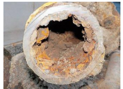
漏水や濁水(赤水)の原因となっている老朽管
