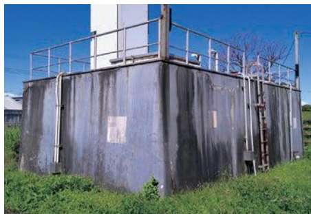
老朽化が進行している浄水施設(第二浄水場)
