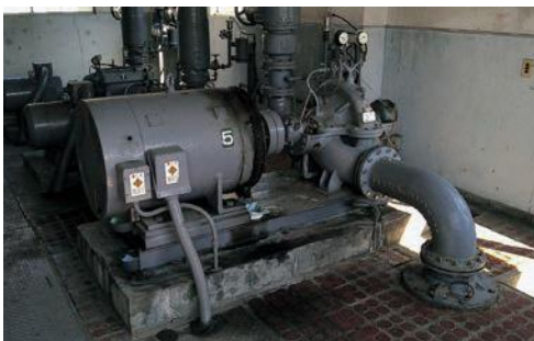
法定耐用年数を超え老朽化が進行している配水ポンプ(第一浄水場)
