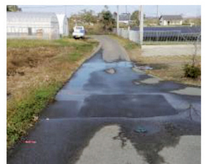
漏水が発生している様子
