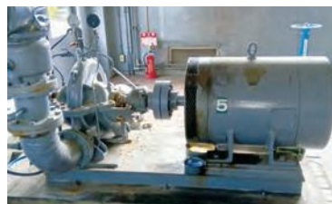
老朽化した配水ポンプ
