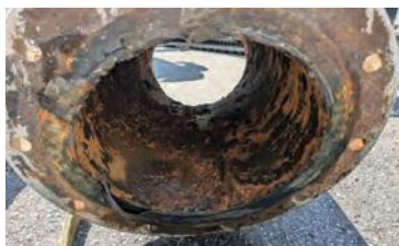
漏水や濁水（赤水）の原因となっている老朽管
