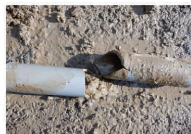
(破損した水道管)
