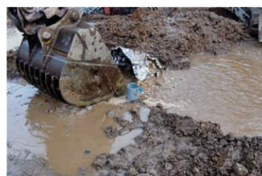
(水道管破損の様子)
