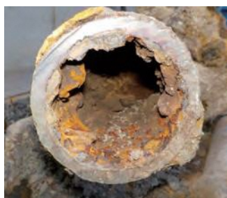
●老朽化による管内部の腐食状況
