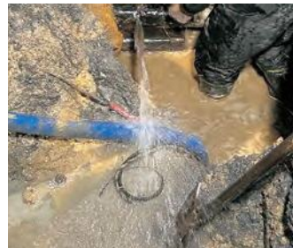
●配水管から漏水している様子
