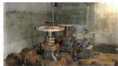
● 高柳配水場場内配管
