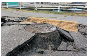
・浮上して段差が発生したマンホール
