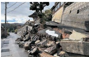
・擁壁が崩壊した道路
