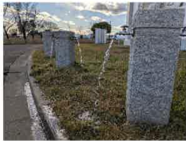
第二浄水場 応急給水栓
