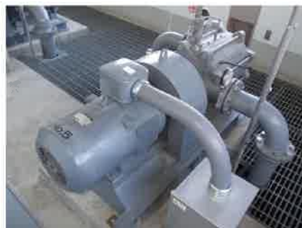
更新予定設備（下真下受水場送水ポンプ）
