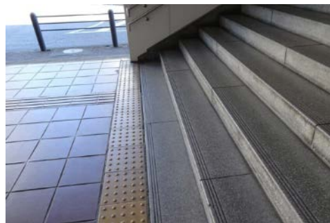
▲コントラストのない段鼻部(47) 1列の視覚障害者誘導用ブロック(48)
