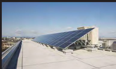
▲校舎屋上の太陽光発電装置
