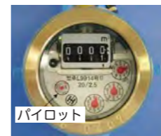
メーター器内のパイロット
