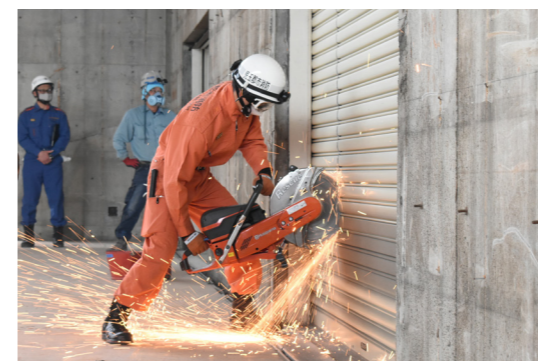
解体工事業業者立ち合いのもと、解体現場で使用する器具なども訓練では使用された
