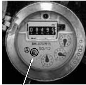
「パイロット」ここで漏水がわかります
