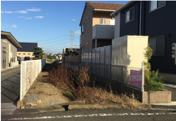
悪臭や雑草が繁茂する水路
