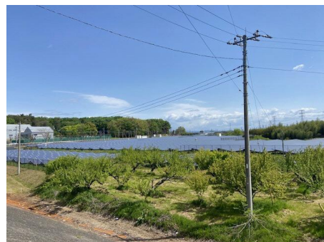
▲栗崎地区南側の太陽光発電施設
