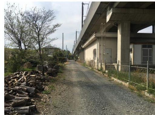
舗装されていない道路
