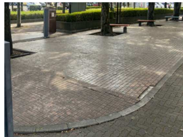
ホワイエ出入口付近、ロータリー周辺等のタイル剥がれ。
